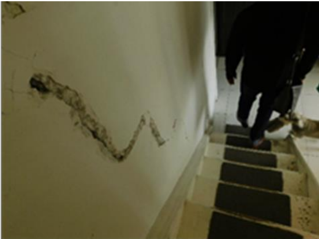
Figura 4: grieta en muro divisorio de escalera en departamento de primer nivel, ocasionada por el sismo del 19 de septiembre de 2017. Fotografía del autor.
